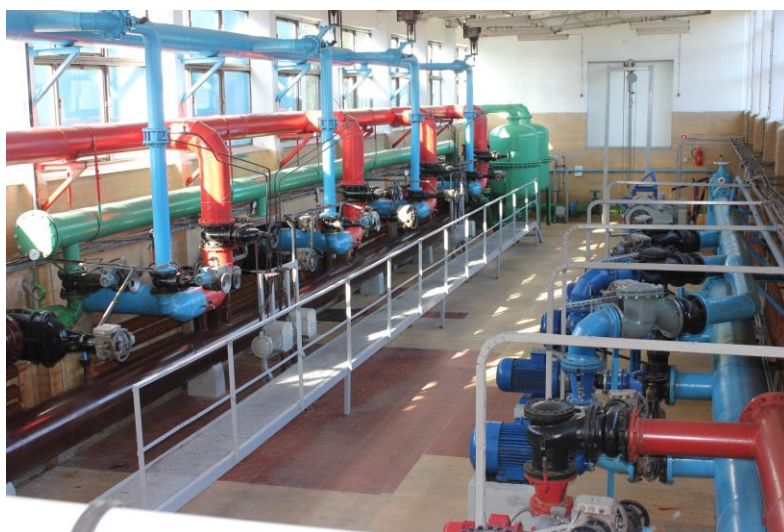
Hala pomp Stacji Uzdatniania Wody w Załęczu
