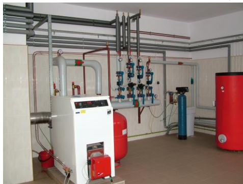
Kotłownia Stacji Uzdatniania Wody w Załęczu
